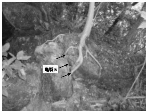
写真4 木の根が入り込んでいる亀裂5
